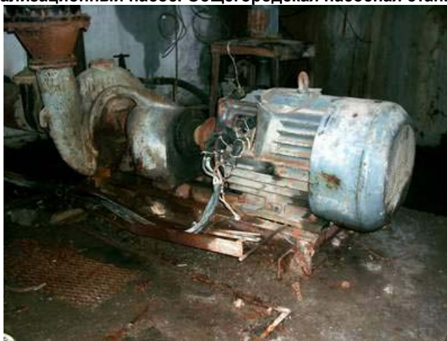
Рисунок 2.1 Канализационный насос. Общегородская насосная станция. г.Масис
