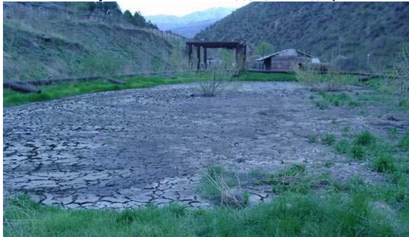
Рисунок 2.12 Иловые площадки, г. Ванадзор
