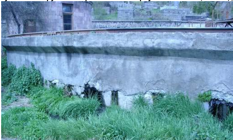
Рисунок 2.16 Нарушение герметичности корпуса отстойника, г. Ванадзор
