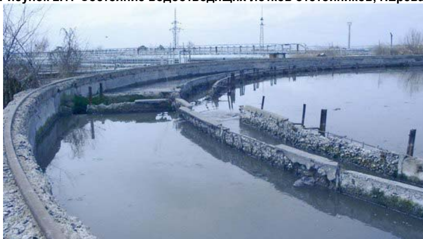
Рисунок 2.17 Состояние водоотводящих лотков отстойников, г.Ереван
