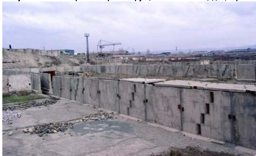
Рисунок 2.19 Незавершенная реконструкция иловых площадок, гЕреван
