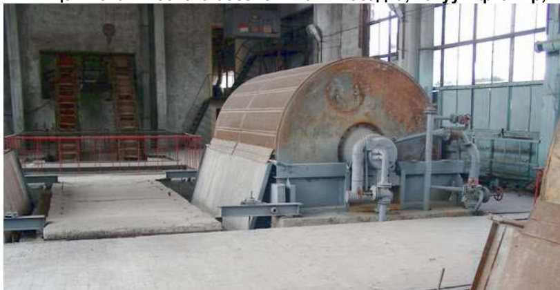
Рисунок 2.11 Цех механического обезвоживания осадка, вакуум-фильтр, г. Ереван
