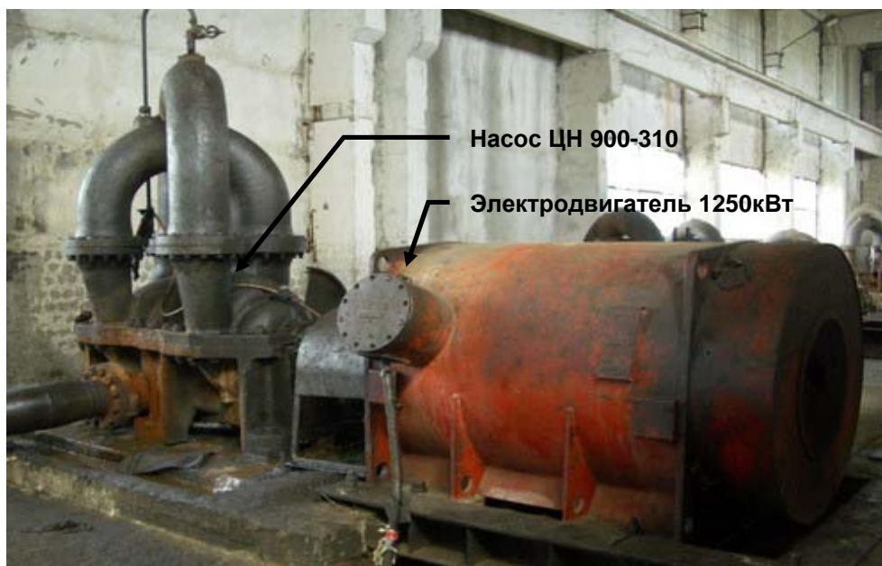
Рисунок 0.4 Насосная станция второго подъема. Насос ЦН 900-310.
