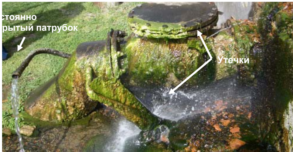
Рисунок 0.6 Повреждение напорной трубы на водозаборе.
