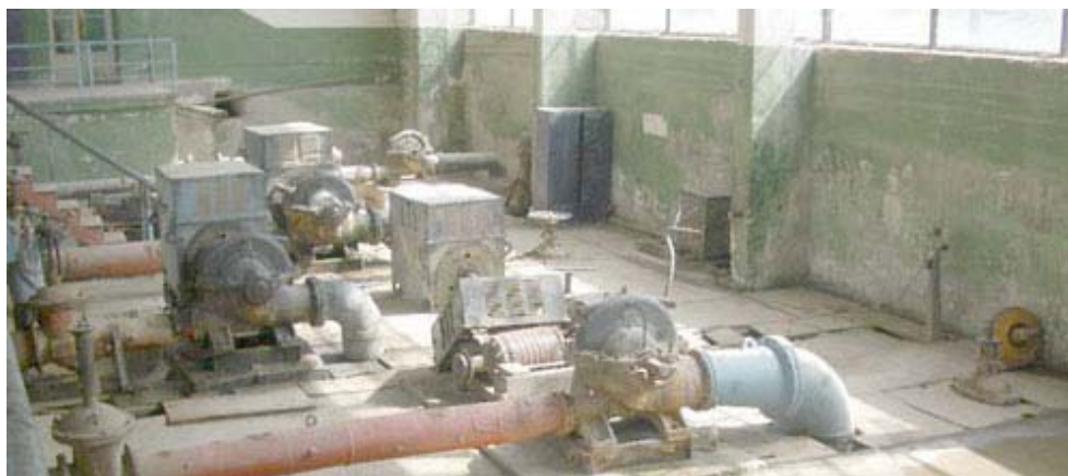
Рисунок 0.2 Насосная станция второго подъема. Насос Д 1250-125.
