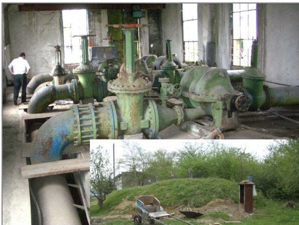
Рисунок 0.2 Насосная станция второго подъема и резервуар чистой воды (РЧВ) V=500 м 3 .
